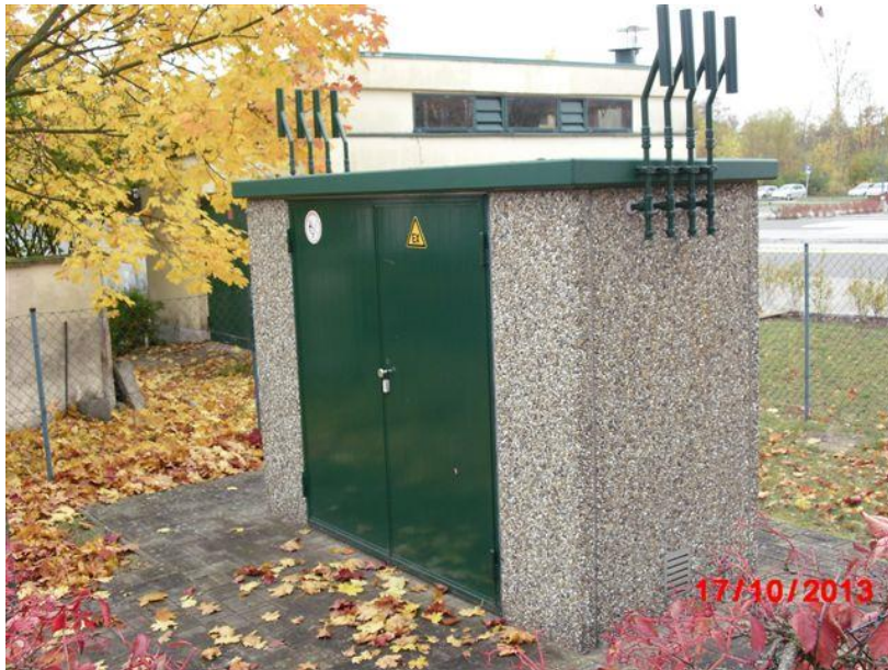
Abbildung 3: Gebäudeansicht einer zweistufigen Regelanlage
